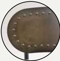
Buffer marks Traces de sablage
